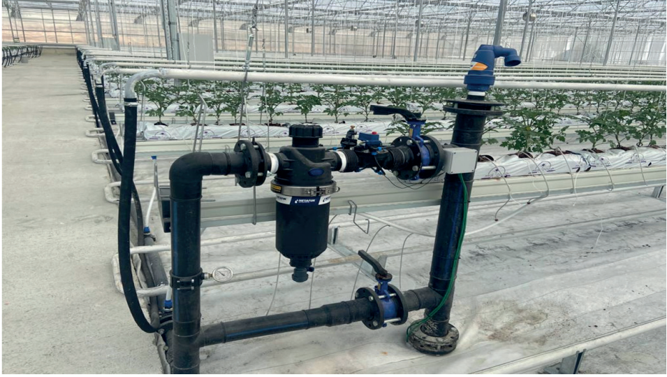
Şekil 29. Sera içerisinde bulunan parsel vanası ünitesi
