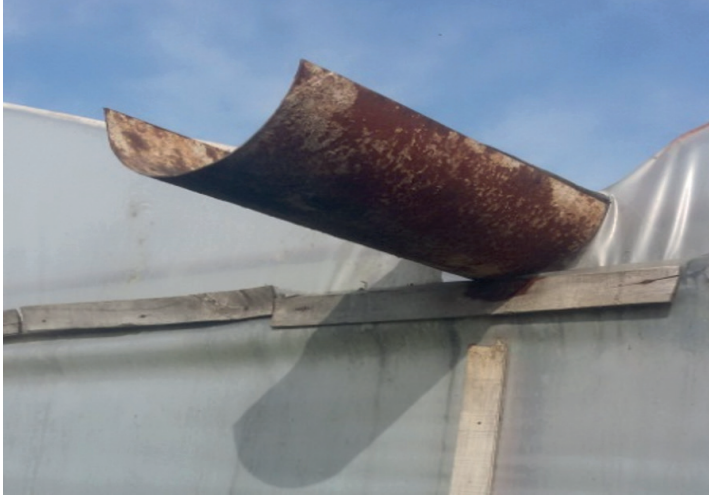
Resim 2. Oksidasyon nedeniyle olukta korozyon oluşumu.
