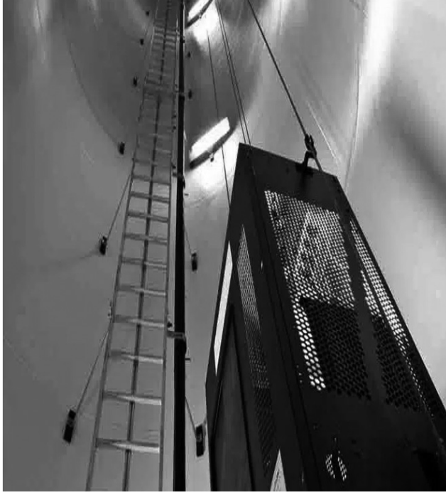
Resim 6. Kule Asansörü (Kapıcı, Emekli Elektrik Müh.)
